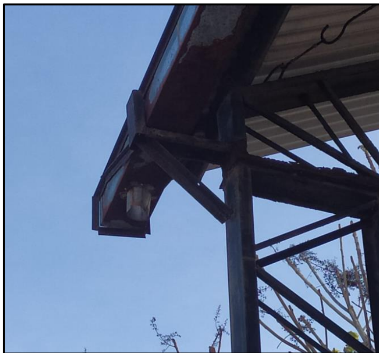
Figura 13: Calha sem tubo de escoamento
