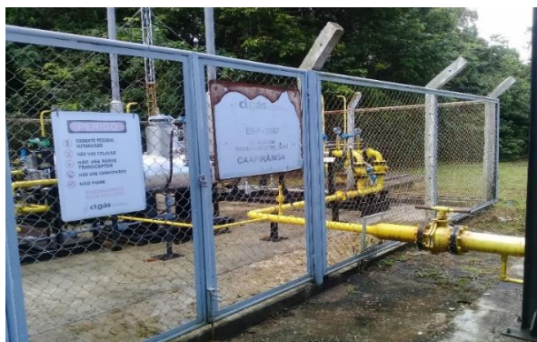
Figura 3- Placa de identificação da ERP da UTE Caapiranga
